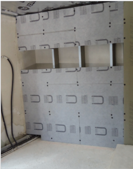
■ Im Duschbereich wurden werkseitig abgedichtete Bauplatten auf eine Unterkonstruktion in Rippenbauweise aufgebracht.
